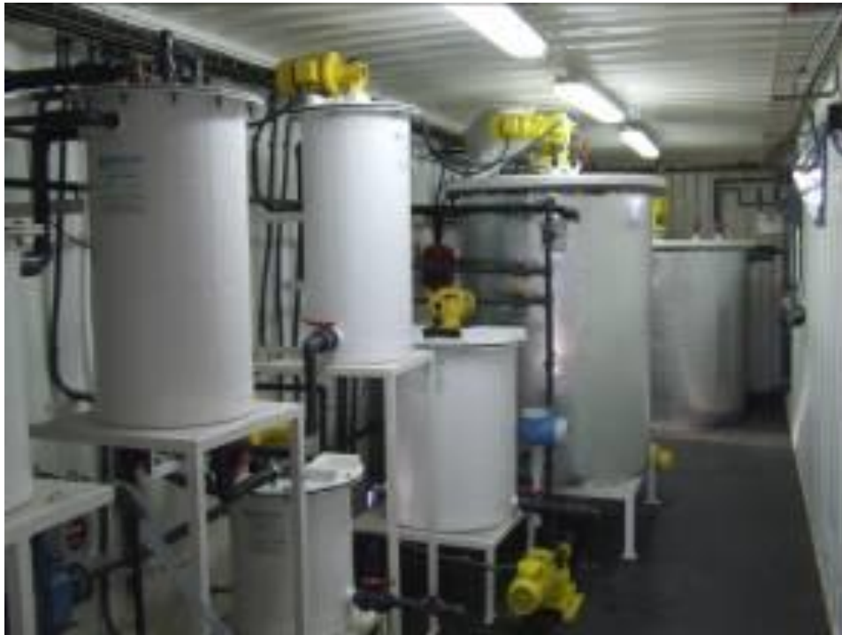
Figura 31. Interior de la planta piloto.
