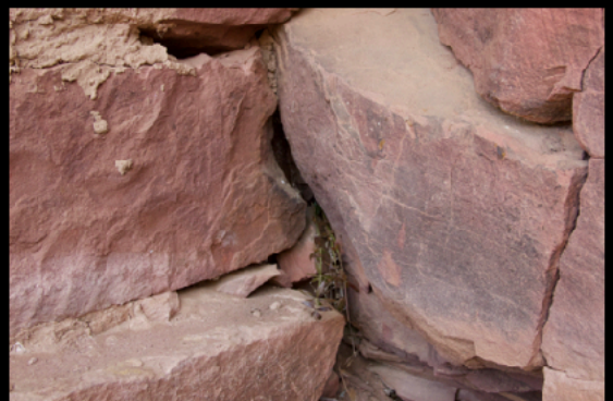
Fig.105. Sedimentación de polvo y fractura del soporte.
