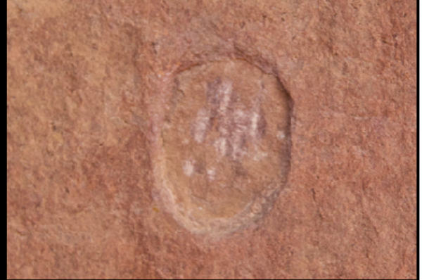
Fig.119. Agresión antrópica: daño mecánico.
