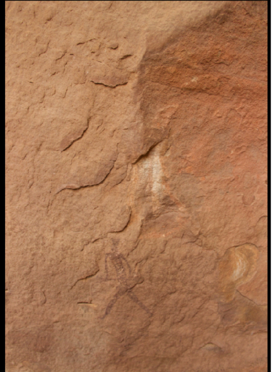
Fig.117. Descohesión del soporte y eflorescencias salinas sobre la figura del arquero.
