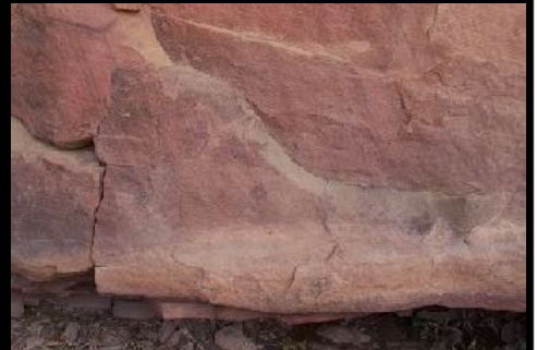
Fig.76. Fractura en la zona inferior izquierda del bloque.
