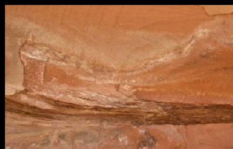
Fig. 71. Detalle de eflorescencias salinas por filtración en el techo del abrigo.
