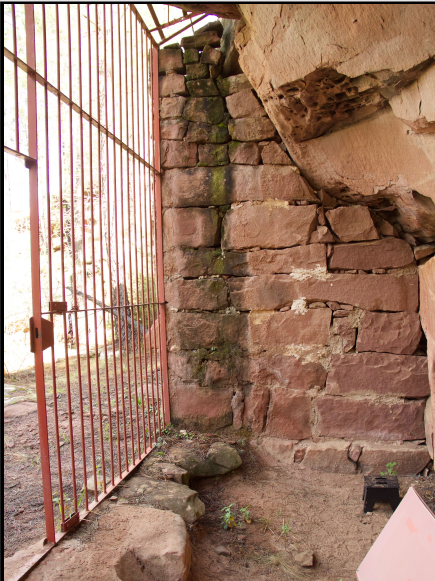
Fig. 72. Filtración de agua de lluvia en el abrigo.
