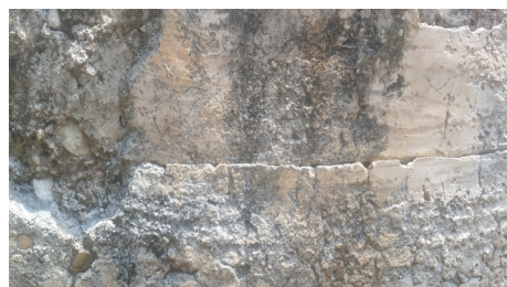
Fig. 29. Grietas que se convierten en lagunas.
