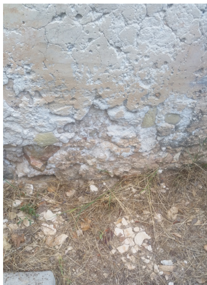
Fig. 34. Desprendimiento de la pintura mural.
