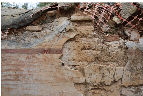
Fig. 10. Estado de conservación de la pintura.
