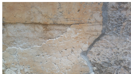
Fig. 30. Pérdida de mortero en zonas perimetrales.
