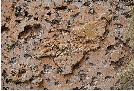
Fig. 31. Detalle de la zona de faltantes irregulares.
