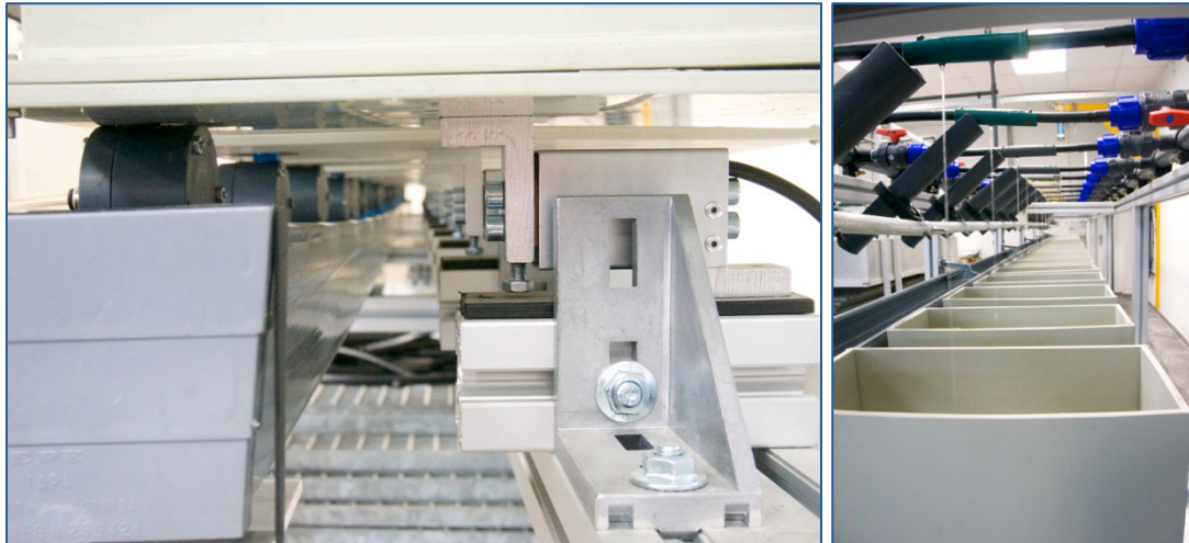
Fotografía 2: Tolvas, desviador llenado, células de carga y válvulas neumáticas de vaciado.
