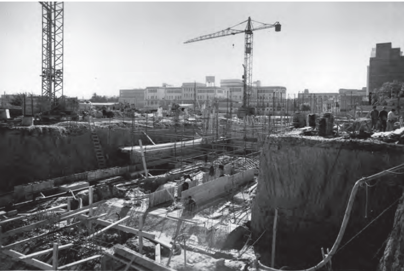
Figura 4. Vista de las excavaciones realizadas para la cimentación del Edificio Principal o volumen "A". 14 de noviembre de 1959. Pablo Navarro Alvargonzález / Figure 4. View of the excavations made for the foundation of the Main Building or volume "A". November 14th, 1959. Pablo Navarro Alvargonzález.
