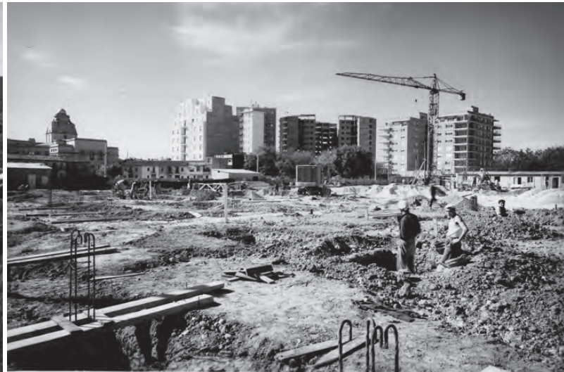
Figura 5. Imagen de visita de obra. Al fondo los edificios de la Cooperativa de Químicos y Elcano de Pablo Navarro también y otro de Luis Gutiérrez Soto en proceso de construcción. Al frente, armaduras de espera de acero Torstahl. 14 de noviembre de 1959. Pablo Navarro Alvargonzález / Figure 5. Work visit image. In the background the buildings of the Cooperativa de Químicos and Elcano by Pablo Navarro also and another one by Luis Gutiérrez Soto in the process of being built. In front, waiting armours of Torstahl steel. November 14th, 1959. Pablo Navarro Alvargonzález.
