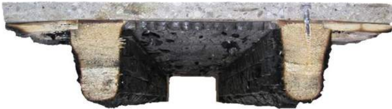
Fig.7 Vigas parcialmente carbonizadas tras un incendio de una duración aproximada de cuatro horas. Aparentemente por fuera puede parecer que la viga este debilitada completamente, pero en la sección observamos que conserva alrededor de un 80% de su canto útil inicial.
