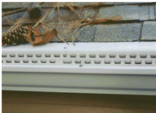
Ilustración 45. Sistema Louvered de filtro en la canalización
