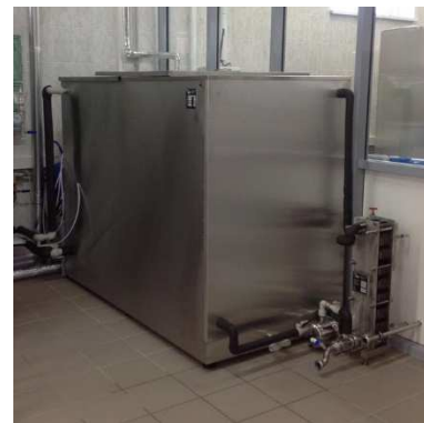
Ilustración 19 Tanque agua fría
