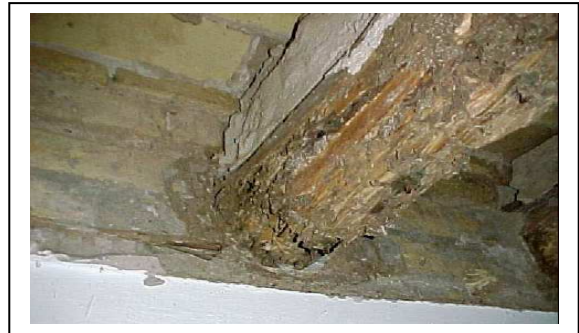
Fig. A1.1.13. Daños producidos por Carcoma gruesa .
