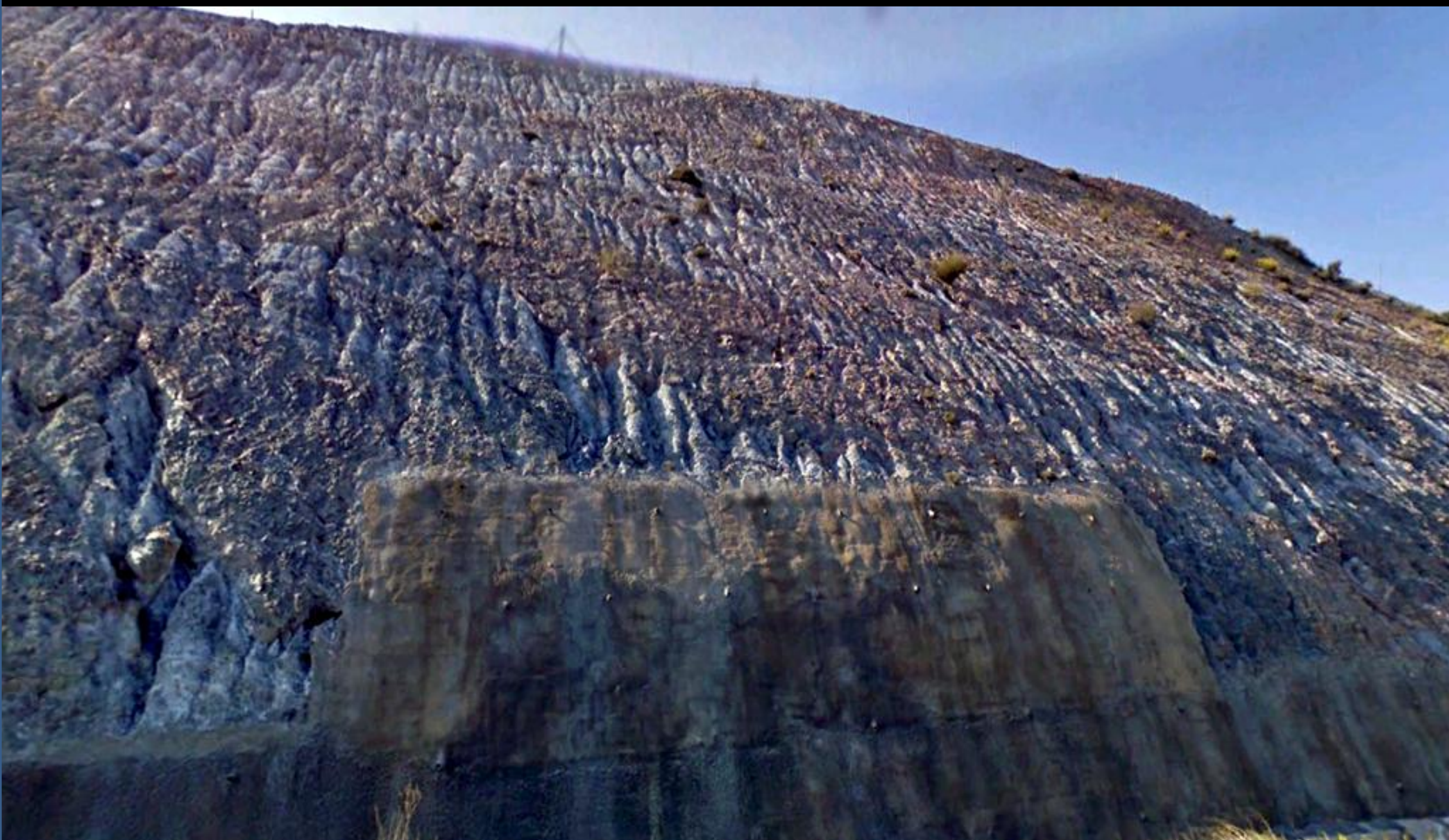
Gunitado para la estabilización del talud de argilitas Permo-Triásicas. SW de Lorca, Murcia. N Hoja de Puerto Lumbreras.
