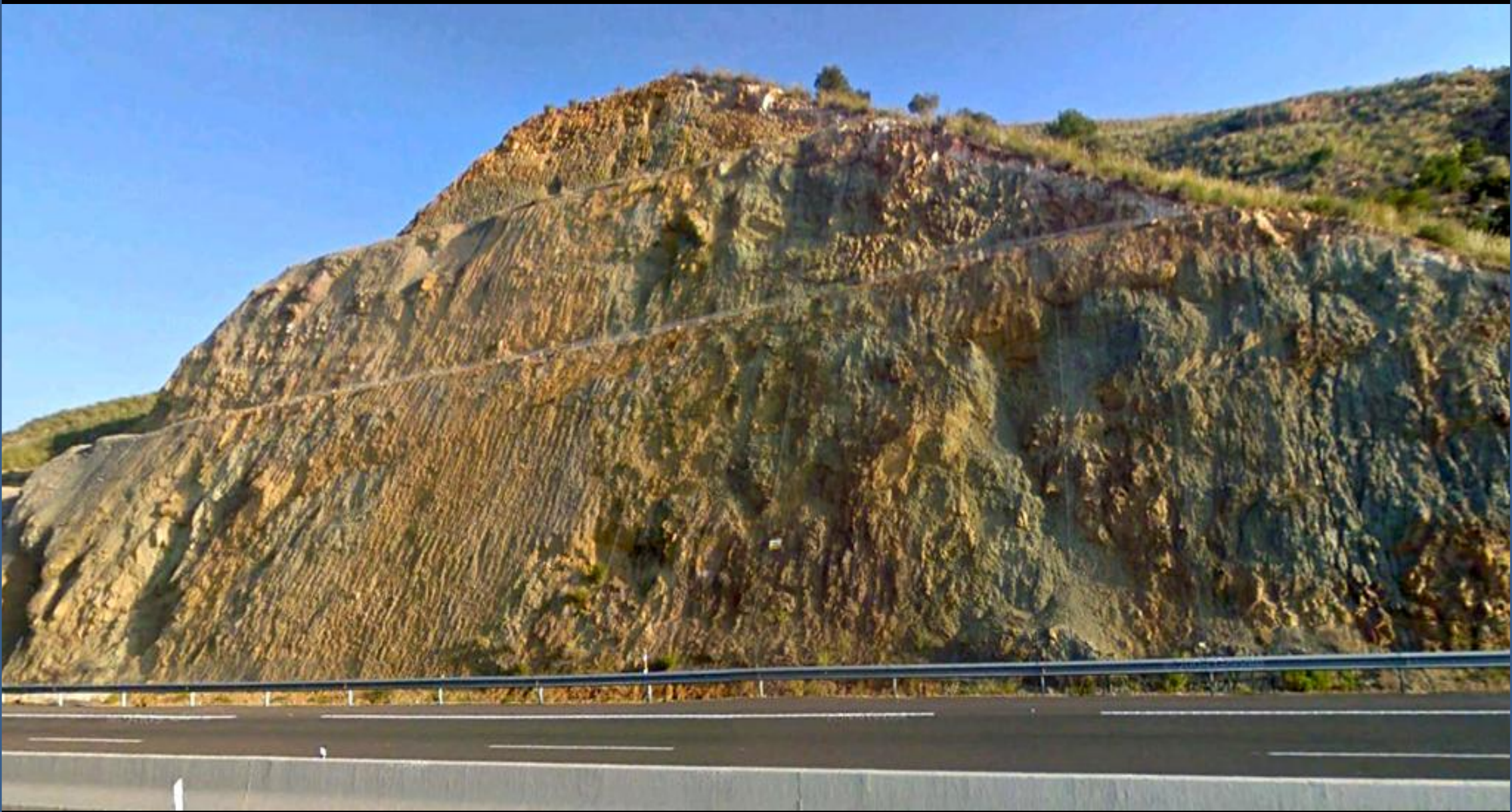
Triásicos tectonizados, con mallazo. Taludes de la Autopista del Mediterráneo. Centro NE -Hoja -de Mazarrón.
