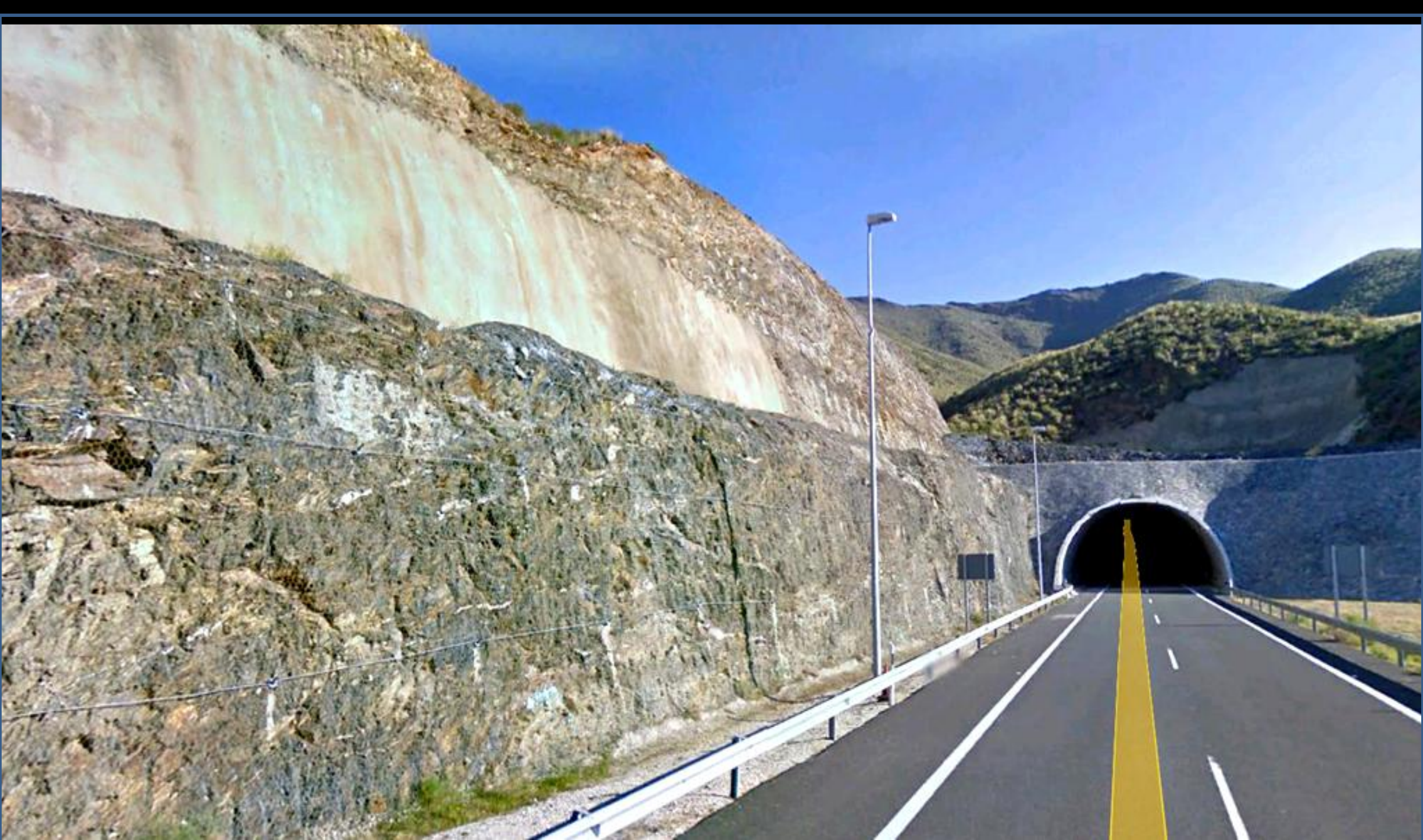
Actuaciones para la estabilización de taludes de los micaesquistos tectonizados del Cámbrico-Pérmico. Autopista del Mediterráneo. SW Hoja de Mazarrón, Murcia. SE de Yegua Blanca.
