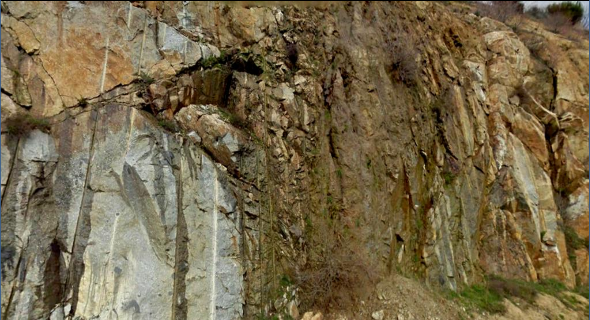
Salidas de agua en los granitos biotíticos, fuertemente diaclasados, del estribo W del vaso en el Embalse de Baños de Montemayor. NE Hoja de Hervás. Cáceres
