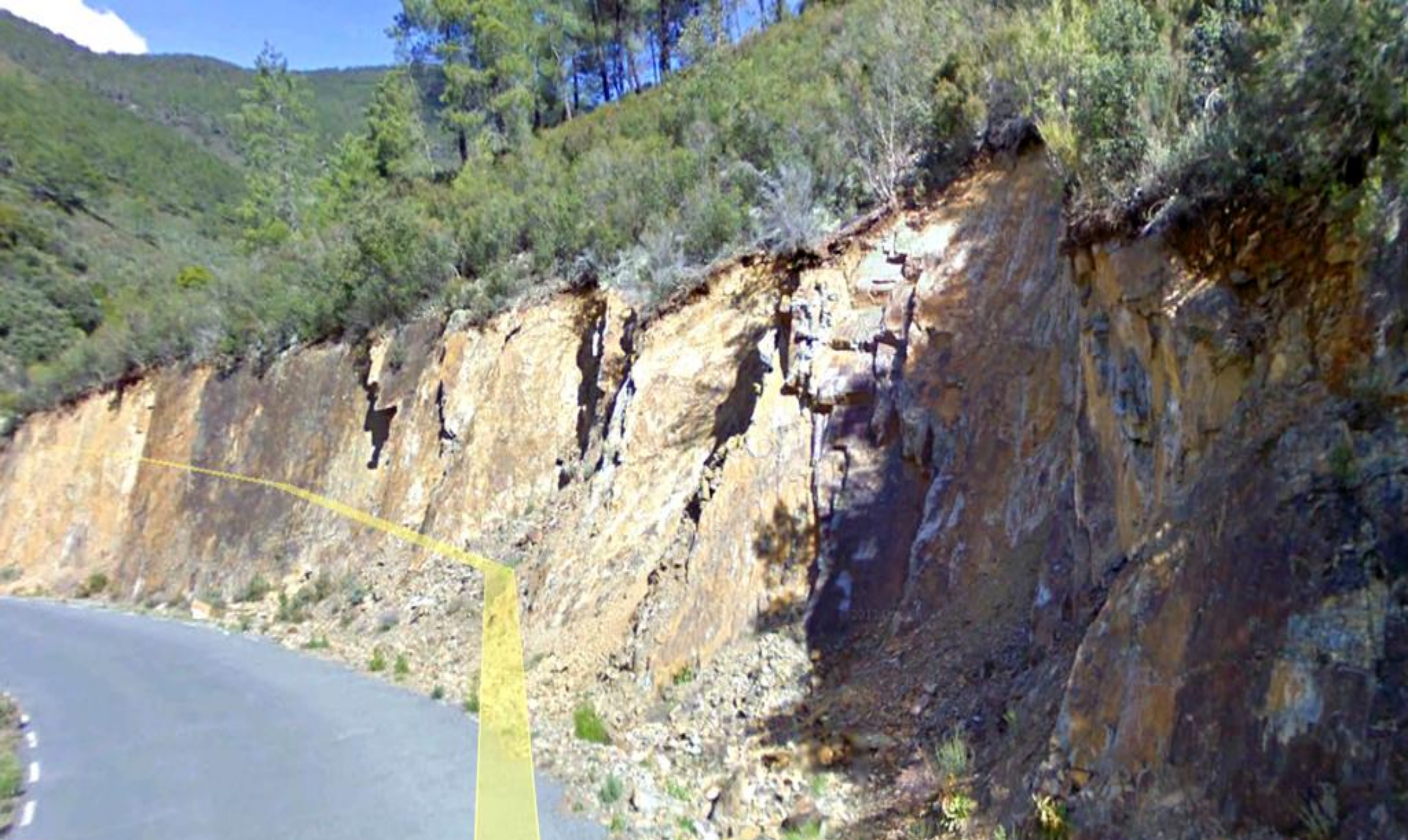
Taludes en las pizarras con fuerte buzamiento del Precámbrico Sup., y con desprendimientos entre planos de esquistosidad. W de Ladrillar, N de Cáceres. NE Hoja de Martiago.
