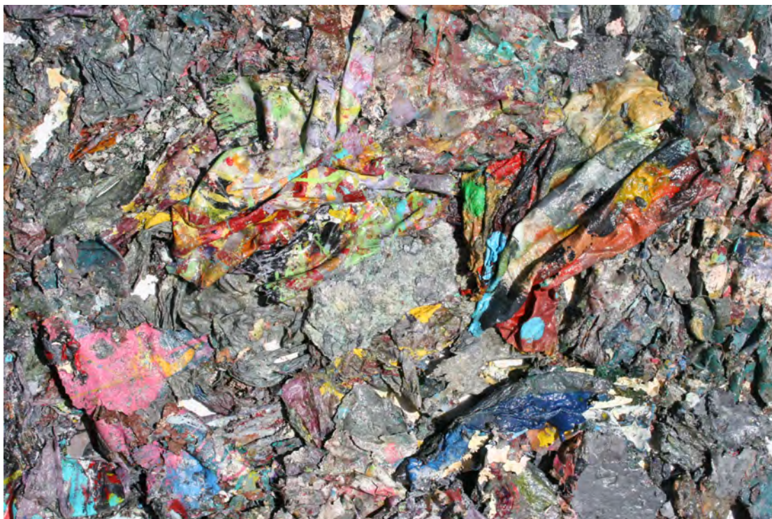
Figura 5 – Detalle de las capas desprendidas del piso.
