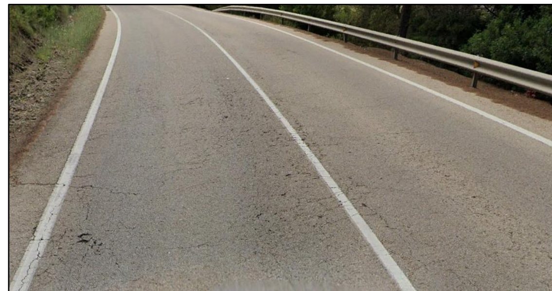
Imagen 13. Degradación de la banda de rodadura. Fuente: Google Earth
