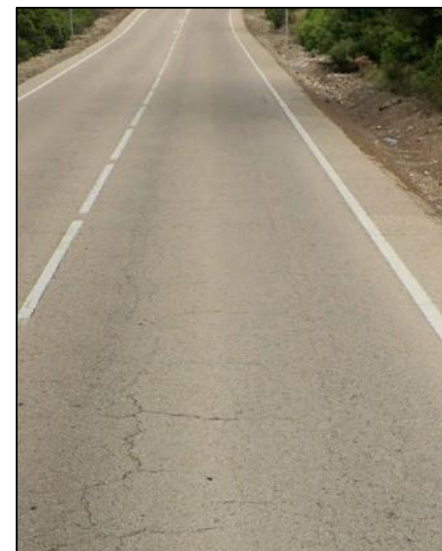
Imagen 14. Degradación de la banda de rodadura. Fuente: Google Earth
