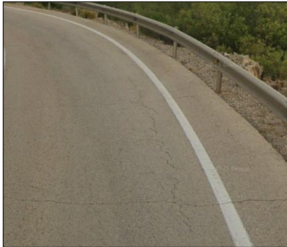
Imagen 19. Fisuras longitudinales. Fuente: Google Earth
