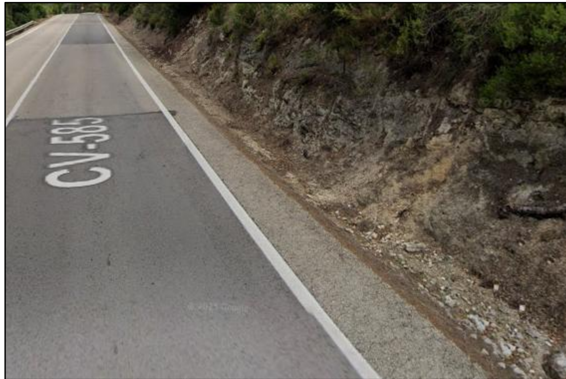
Figura 17. Drenaje longitudinal sin revestir en el P.K. 1+010. Fuente: Elaboración propia
