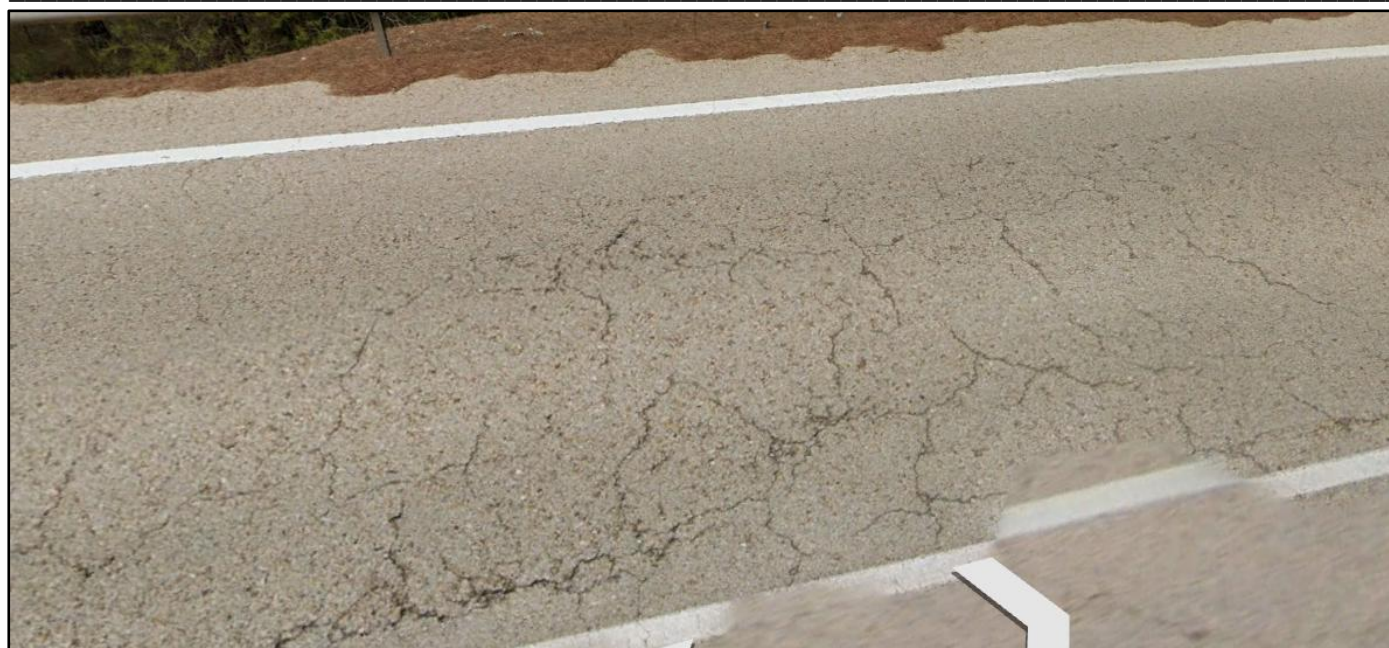
Imagen 15. Fisura “piel de cocodrilo”. Fuente: Google Earth
