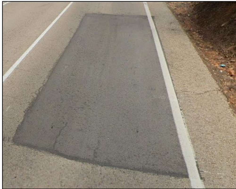
Imagen 22. Parche en caliente. Fuente: Google Earth
