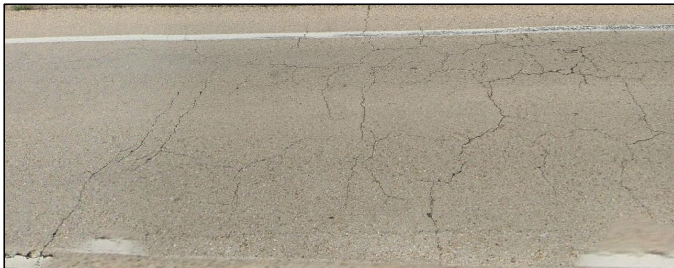
Imagen 16. Fisura “piel de cocodrilo”. Fuente: Google Earth
