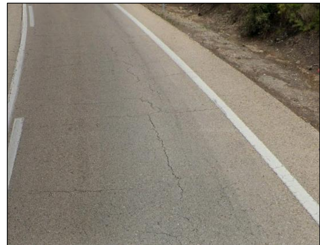
Imagen 18. Fisuras longitudinales. Fuente: Google Earth
