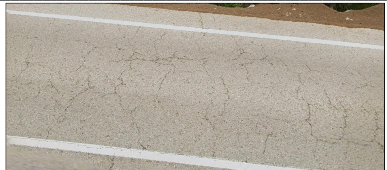
Imagen 17. Fisura “piel de cocodrilo”. Fuente: Google Earth
